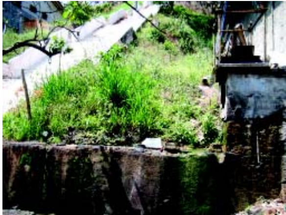
Foto 1: Bica improvisada aos pés de escadaria na rua Dr. Paulo Vieira Crédito: Autor
