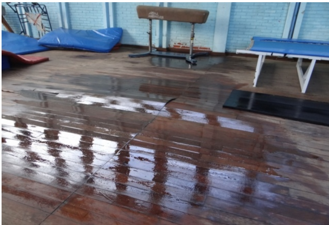
Foto 5: Registram-se as goteiras constantes na universidade em decorrência das fortes chuvas
