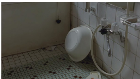
Figura 5 - Plano “morto” detalhe do chão do banheiro
